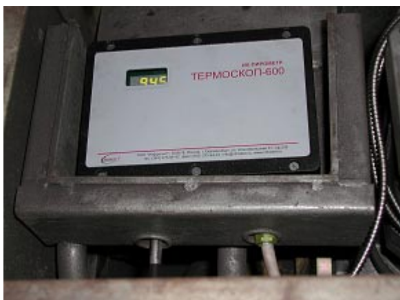
Качканарский ГОК, пирометр Термоскоп-600, контроль температуры окатышей в горне обжиговой машины, оснащены 5 секций зоны обжига
